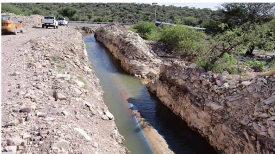
Existe suficiente evidencia sobre las fallas en el acueducto que se supone sólo serían de una ocasión, criticó el mandatario estatal
